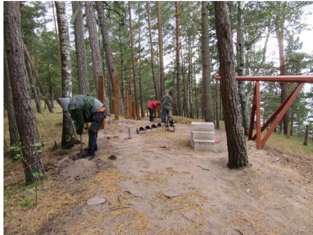
1.1.15.att. Pēc DDP "Baltā kāpa – Saulkrasti" elementa izbūves zemsedze ārpus takas sāk atjaunoties (2019.g.septembris). Jaunās laipas (projekts "Jūrtaka") būvniecības darbu laikā zemsedze tiek ietekmēta atkārtoti.
