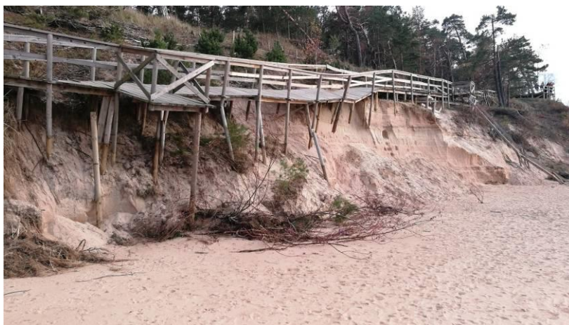
1. Attēls. Inčupe Baltās kāpas piekāvēs ziemeļu daļā 2018.gada oktobrī. Vētras laikā notikusi viļņu izraisīta nogāzes erozija, bet Inčupes gultne aizpildīta ar sanešiem un atvirzījies no nogāzes.
