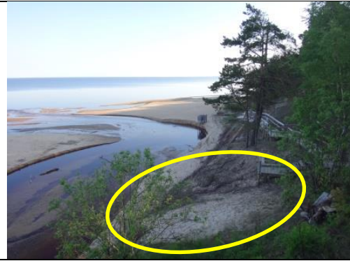
1.2.8.att. Nobradājumu veidošanās (sk.1.2.6.att. apvilks ar dzeltenu) aiz norobežojošām margām pie noejas uz pludmali. Vietas kopskats 2016.gada maijā
